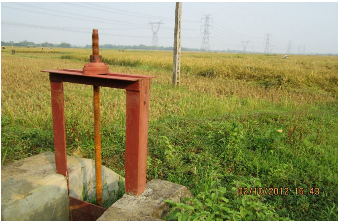
ประตู ปิด-เปิด ระบายน้ำในระบบชลประทานที่ได้รับความช่วยเหลือจาก JICA ที่มา: นักวิจัย
